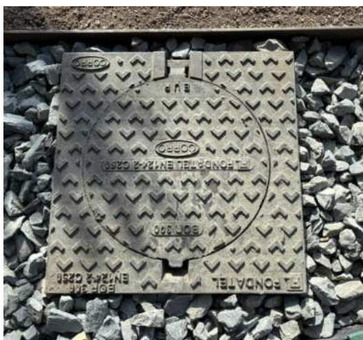
Detailní pohled na uzavřenou šachtu odpadních vod
