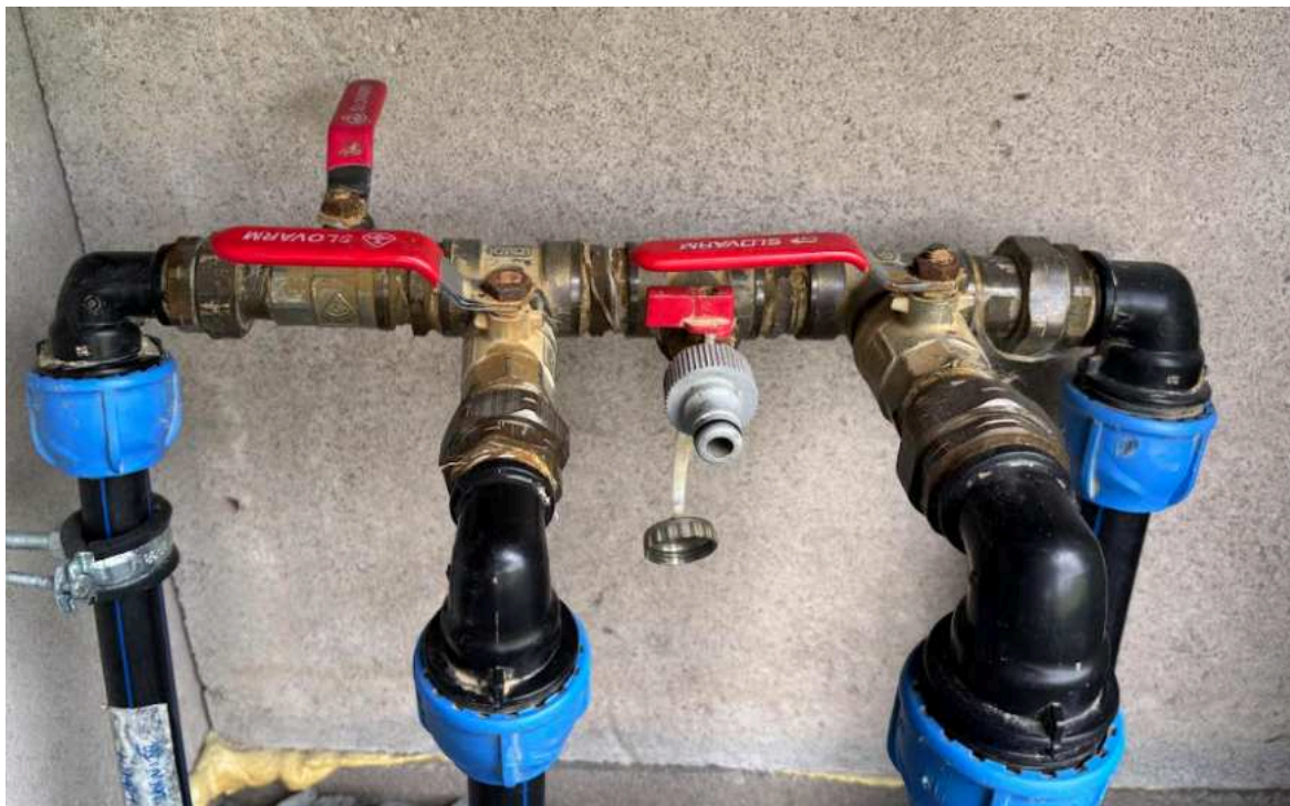
Pohled na ventily ve ventilové budce
