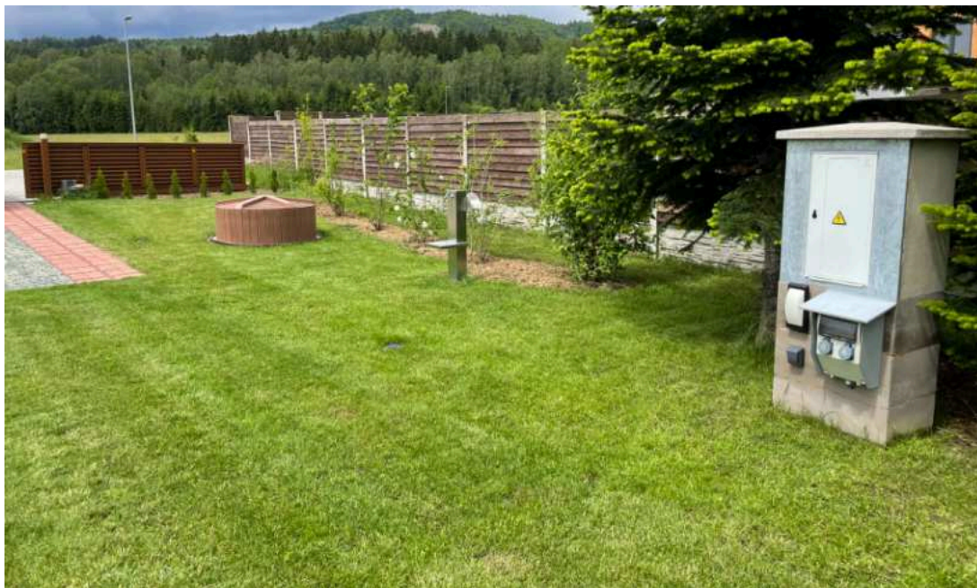
Pohled na vedlejší rozvaděč
