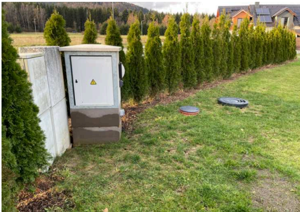
Pohled na hlavní rozvaděč
