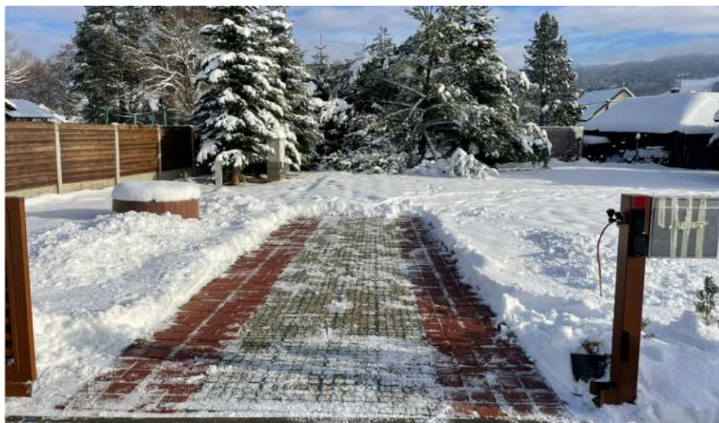
Zimní provoz. Sníh je odklizen jen na prvních osmi metrech stání - tedy tam, kde jsou dlaždice.
