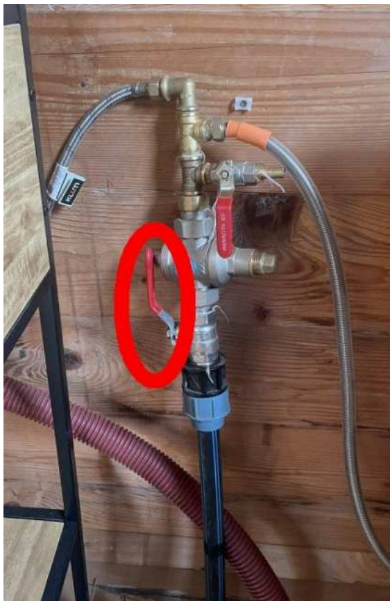
Ventil uvnitř zahradní chatky pro uzavírání přívodu vody pro umyvadlo a WC.
