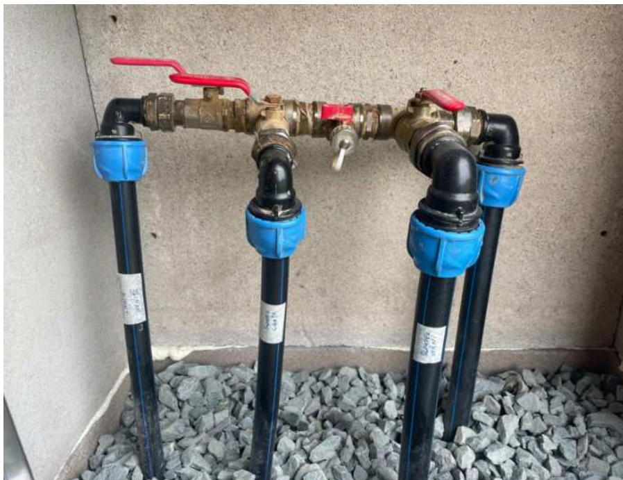
Pohled na ventily ve ventilové budce
