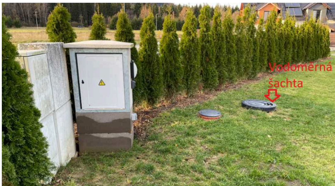
Pohled na hlavní elektrický rozvaděč, vodoměrnou šachtu a kontrolní šachtu svodu dešťové vody
