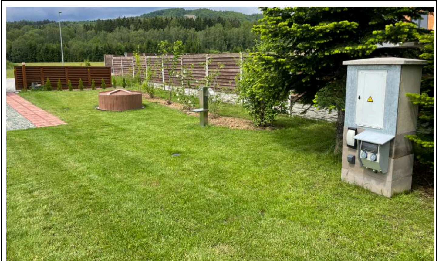
Pohled na vedlejší rozvaděč
